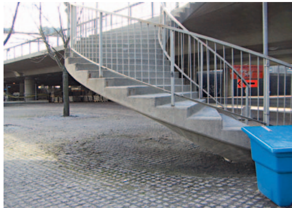
Friliggande trappa som är lätt att gå in i och skada sig på.
