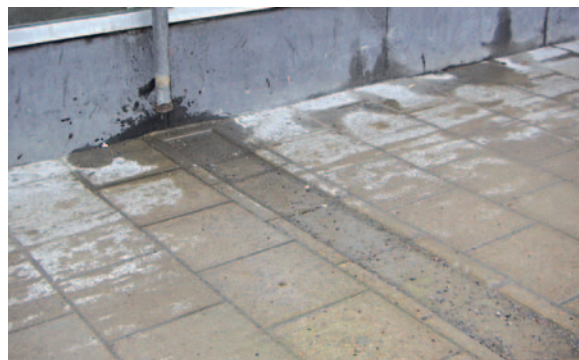
Här har ränn dalen gjorts grundare och bredare. Bäst är att helt täcka över den.
