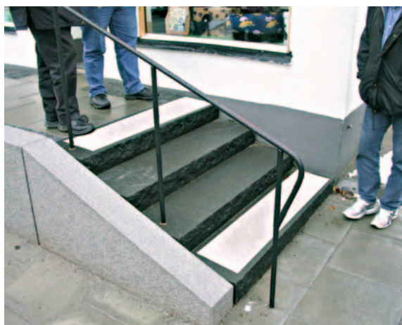
Tydlig markering på första och sista steget. Ledstång saknas på ena sidan.
